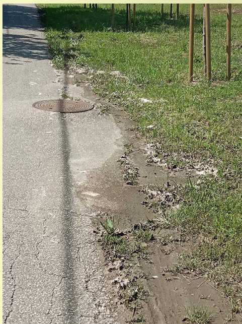
1. kép. A szennyvízknába csapadékvíz bekötés is készült, mert a régi bekötést a főcsatorna építéskor elbontották. Jelentős csapadék esetén a csapadékvíz bekötések túlnyomást hoznak létre a szennyvízcsatornában, ami ennél az aknánál is kiöntött. - Tápé, Rába u. (fotó: Korom A.)
