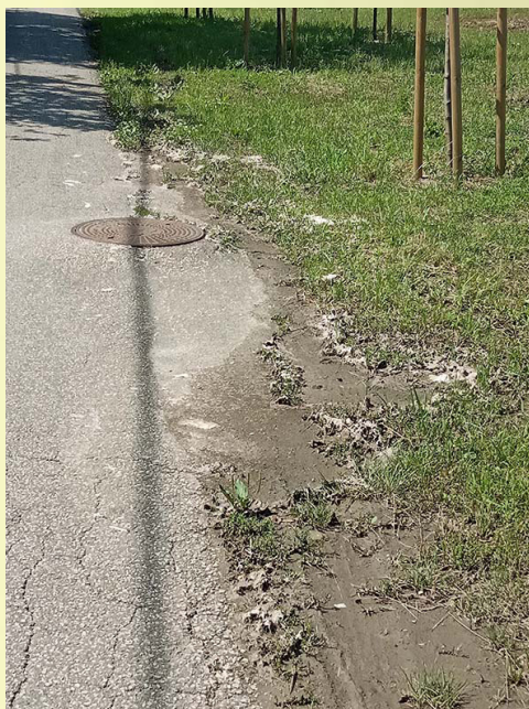
1. kép. A szennyvízknába csapadékvíz bekötés is készült, mert a régi bekötést a főcsatorna építéskor elbontották. Jelentős csapadék esetén a csapadékvíz bekötések túlnyomást hoznak létre a szennyvízcsatornában, ami ennél az aknánál is kiöntött. - Tápé, Rába u. (fotó: Korom A.)
